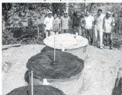
Sistema da fossa biodigestora montado, Monte Formoso
